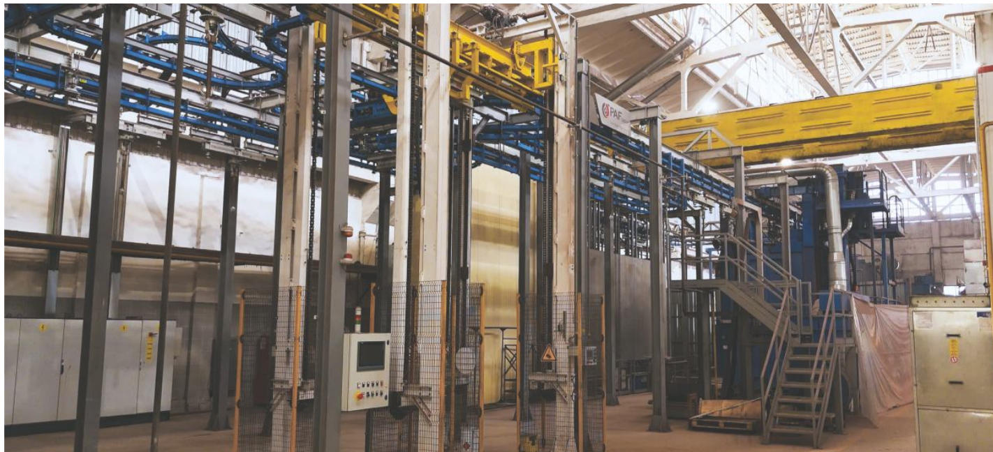
07. Линия окраски радиаторов обливом (производитель - компания «DMA HEAT TECHNOLOGY»)
